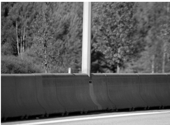
Betongräcke med belysningsstolpe placerad uppepå. E4 södra infarten till Norrköping. Kombinationen är inte godkänd.
